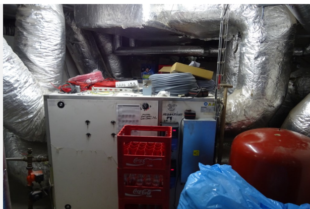
Kotelna zdroj: vlastní
