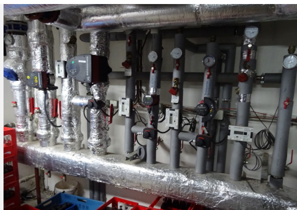
Kotelna - technické rozvody tepla, TUV, vody, MaR
