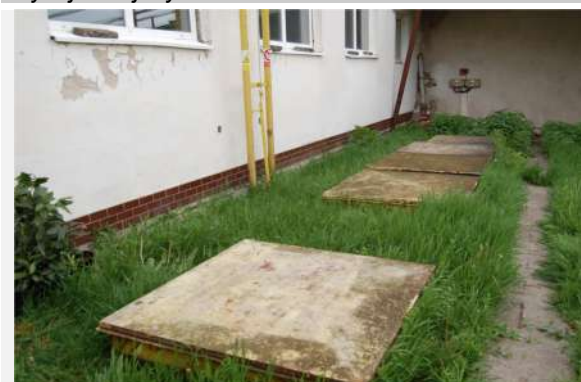
Stáček šachty na PHM (zdroj: vlastní):
